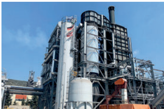
18,5 MW ORC ANLAGE | GRIECHENLAND
