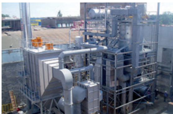
7 MW HOLZSTAUB 3-ZUG-EHITZER | RUSSLAND
