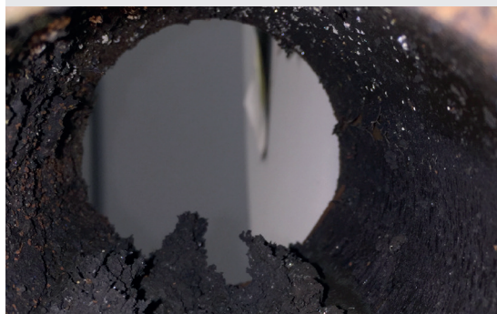
Отложения внутри трубы
